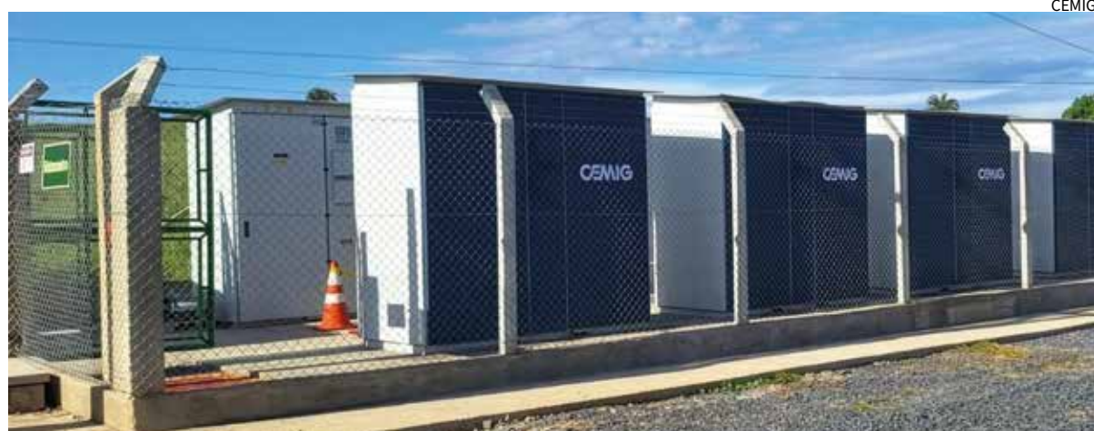
Sistema permite armazenar energia para utilização em horário de maior consumo
